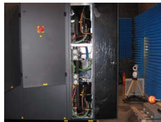
- Figuur 4 - De CSH installatie in de testruimte.
